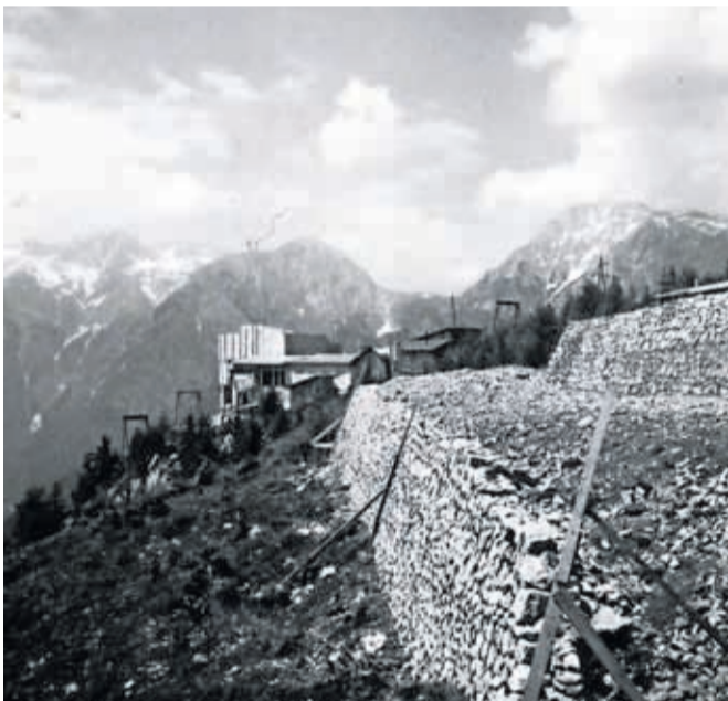
Gradnja zgornje postaje žičnice in priprava terena za hotel Šimnovec, ok. 1960 / FOTO: ARHIV VLASTA KOPAČA
