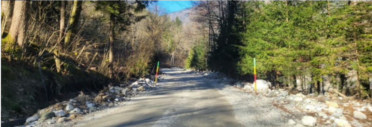
Slika 5: Predmetno območje, pred začetkom sanacijskih del (stacionaža 3.470 m).
